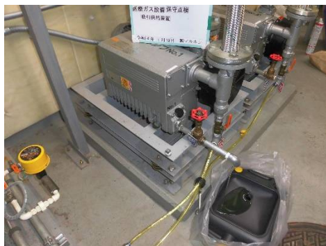
油回転式吸引ポンプからの運転オイル回収状況
