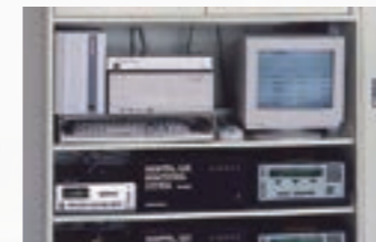
手術室・環境ガス監視システム
